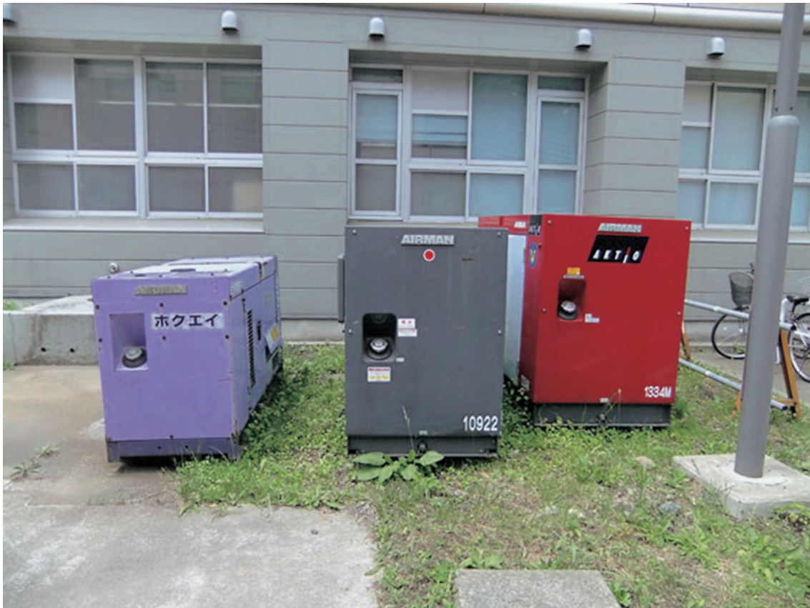
図 1 停電対策のための発電機
