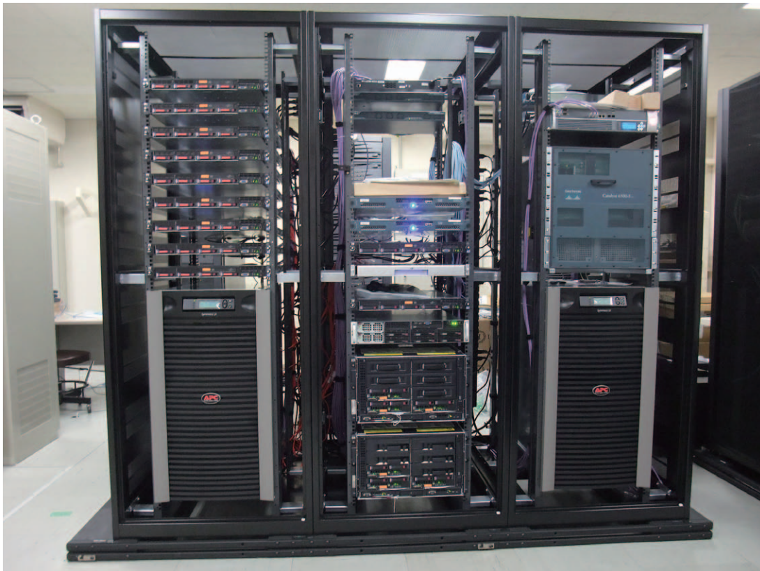
図2 サーバラック
