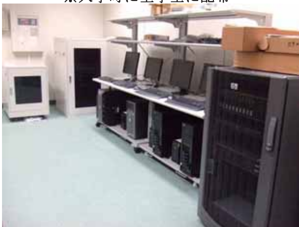
図 3 サーバー管理室
